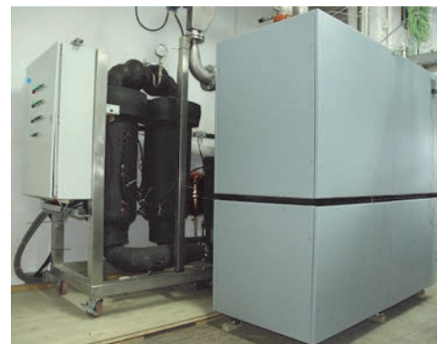
Sprężarkowa pompa ciepła o mocy grzewczej 100kW współpracująca z niskotemperaturowym źródłem ciepła
